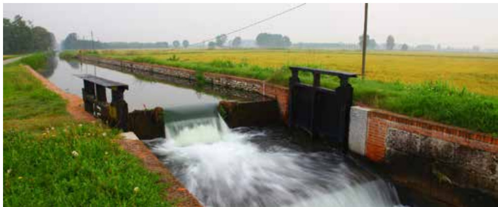
Le chiuse e le conche storiche del Naviglio di Bereguardo nelle campagne tra Abbiategrasso e Morimondo.
